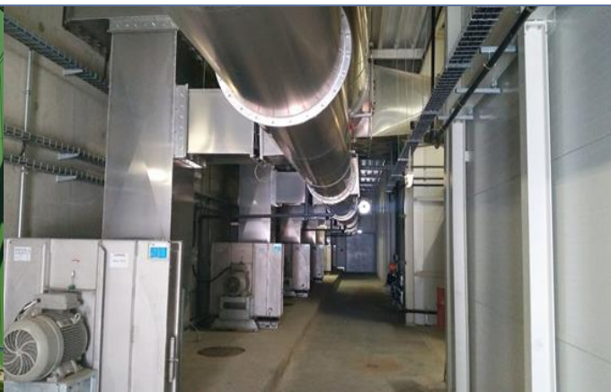
42 pav. Daugybė technologinės įrangos užtikrina tinkamą mikroklimatą įrenginiuose
