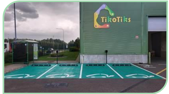
22 pav. įkrovimo stotelės
